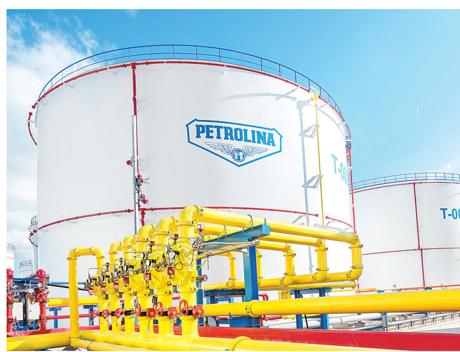
Ο Όμιλος μετέφερε όλες τις υποδομές αποθήκευσης και διαχείρισης υγρών καυσίμων στο Ενεργειακό Κέντρο Βασιλικού. Πρόκειται για εγκαταστάσεις υψηλής τεχνολογίας.
